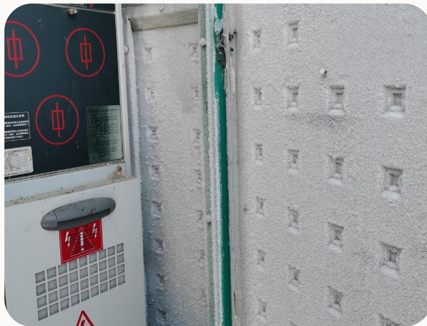
电气设备壳体结霜
