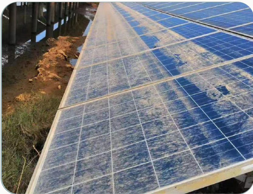
洪水淹没光伏电站
