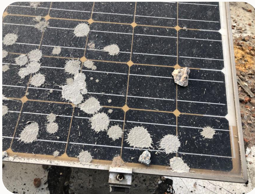
工程建设影响光伏电站
